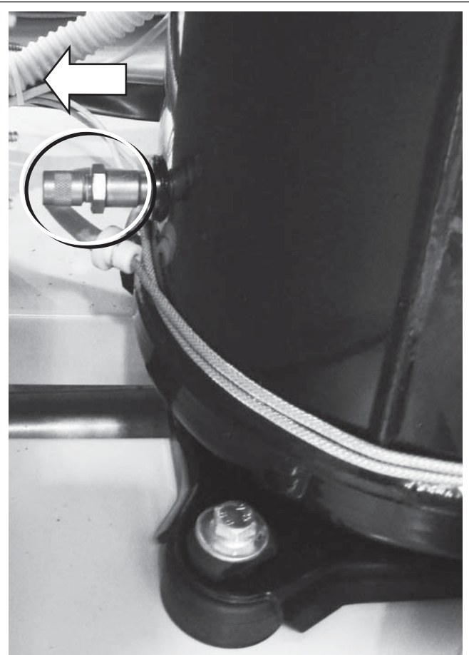
Den Schaltkasten verschieben, um Zugang zur Ölanzeige zu erhalten.
